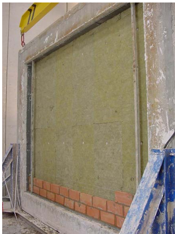
Foto 3: Construcción de fábrica de ladrillo hueco simple de 5 sobre banda perimetral de poliestireno expandido elasticado
